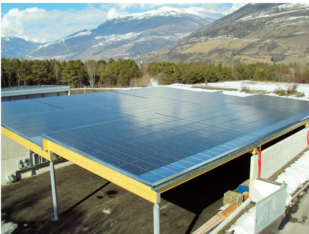
Impianto fotovoltaico Rio Mulino 2
